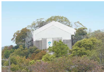
<工事中の当館全景> (足場と素屋根のテントに覆われています)
